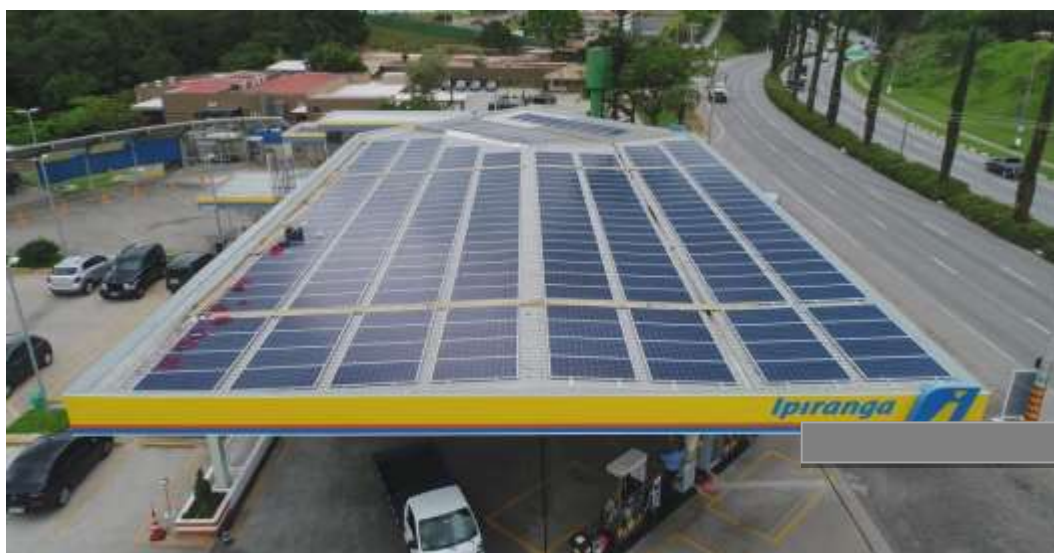
Figura 2. Painéis solares implantados no posto 1. Fonte: Solucione, (2019).
